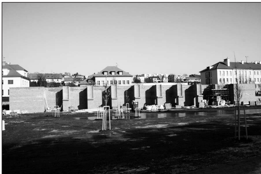
Pohled na budovanou ohradní zeď s nikami v lednu 2012 (Foto P. Hudec)
